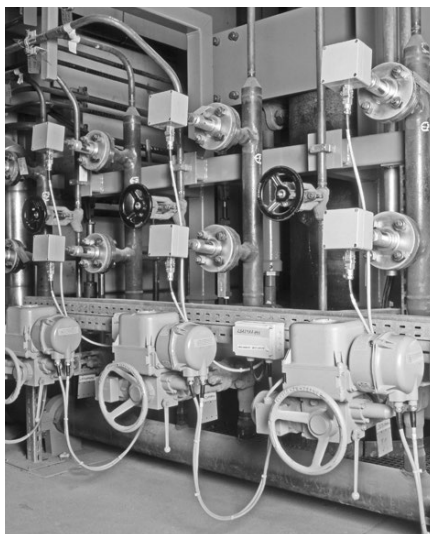
排水站/排放调节站中带电动驱动器的 ZK 29
